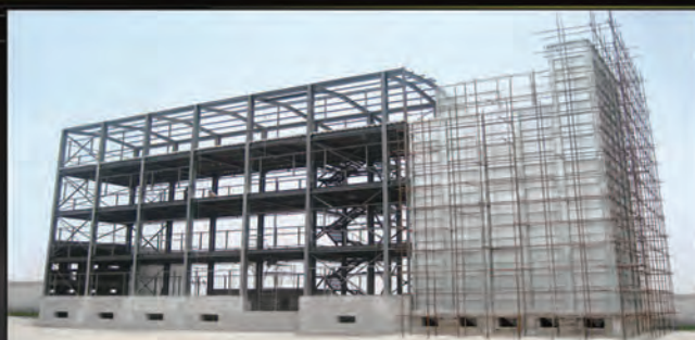
◆ 全钢结构楼房成套制粉工程
